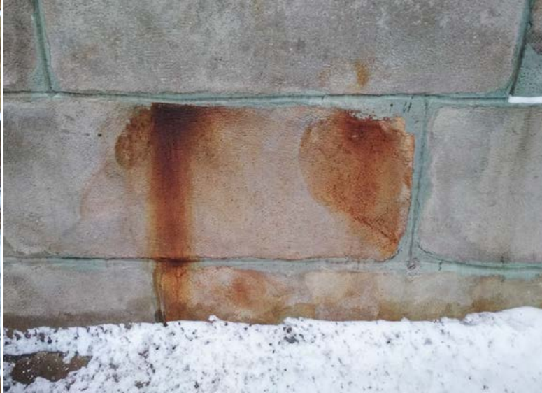
Пятна ржавчины на пьедестале Царь-пушки
